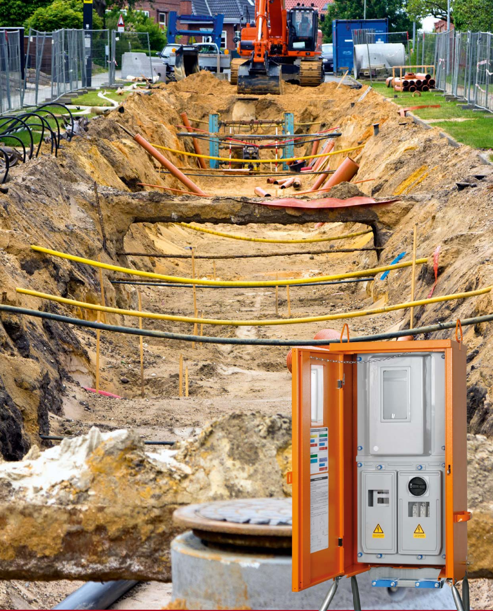
ANSCHLUSS- UND ANSCHLUSSVERTEILERSCHRÄNKE VERSORGUNGSGEBIET „VATTENFALL“
