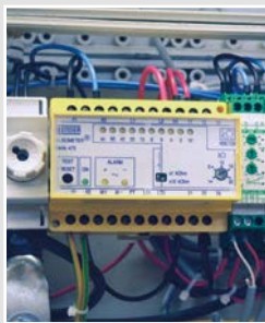
Isolationsüberwachung der 1.000V Strecke, Traforaum zwangsbelüftet
