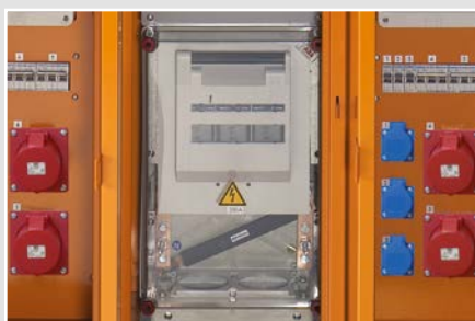
Abgänge mit CEE-Steckdosen
