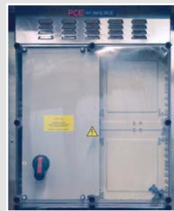
Eingangsseitiger Trennschalter zum Freischalten des Abwärtstrafo
